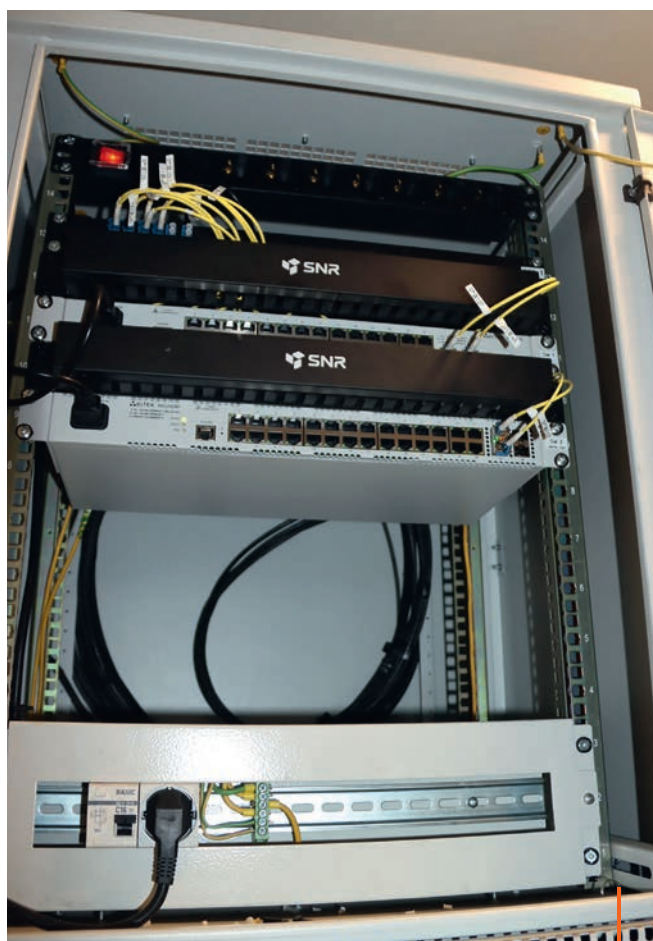
Новый шкаф сетевого оборудования
